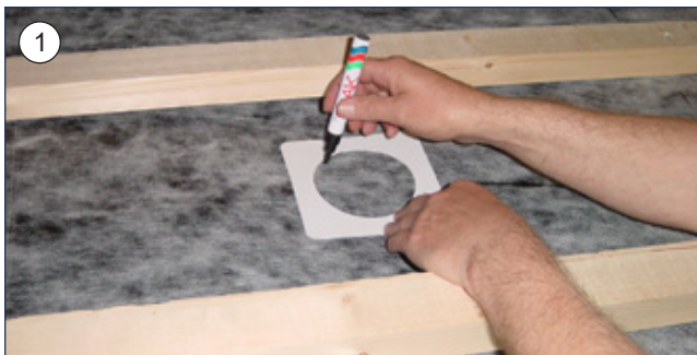
1. A mellékelt sablon segítségével meghatározzuk a szellőzőgyűrű helyét a tetőfólián, és jelölőfilccsel a sablon mentén körberajzoljuk.
