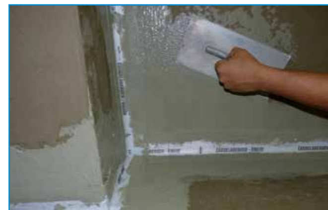
A hajlaterősítés beágyazása után a teljes felületre felhordjuk a második réteg vízszigetelést.
