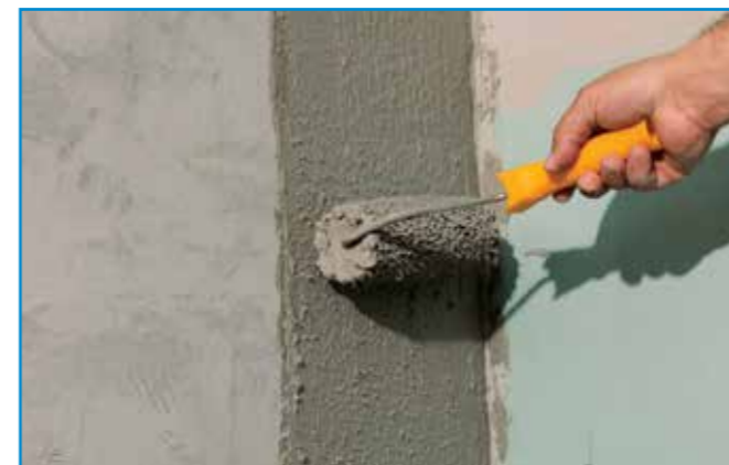
A kenhető szigetelés első rétegét a teljes felületre, sarkokba, élekre is kenjük fel.
